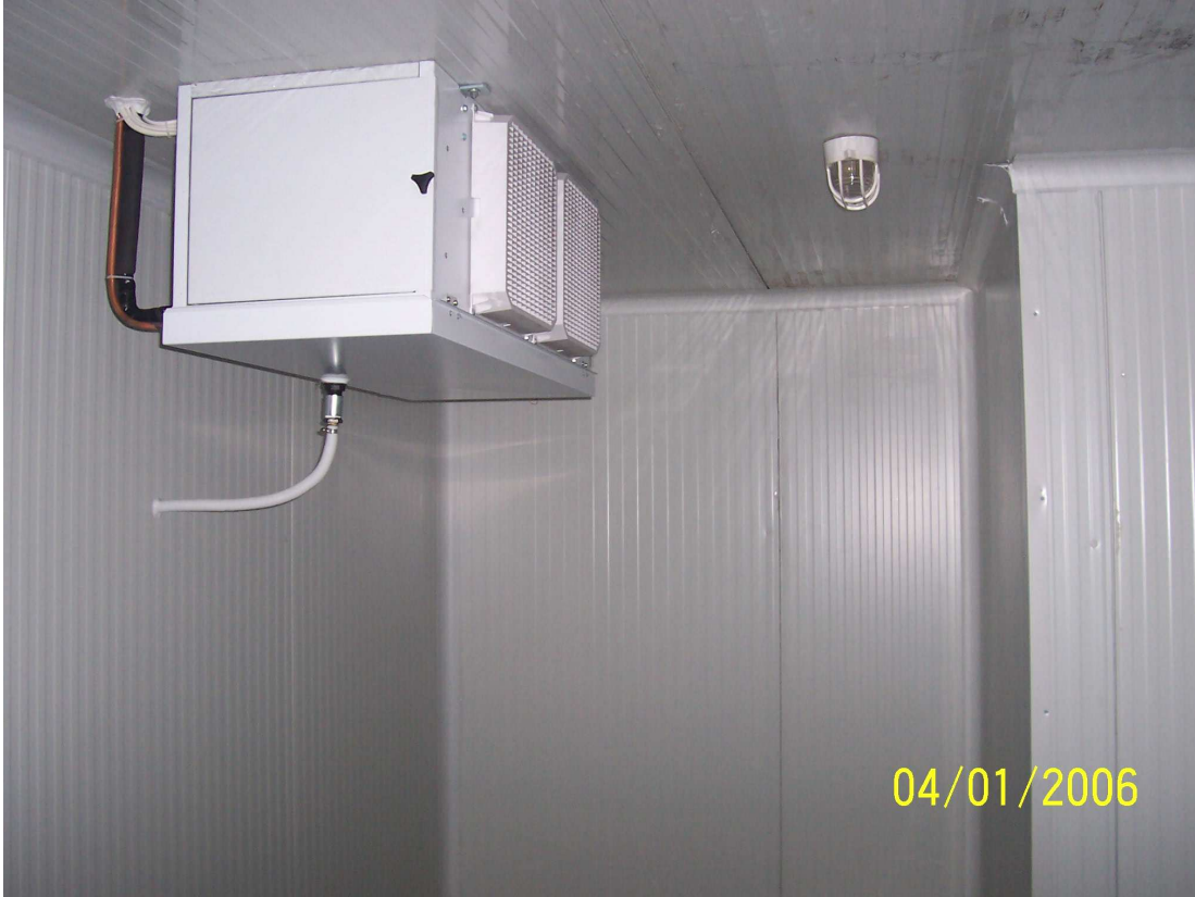
Soğuk Depo Evaporatörünün Yerleşimi
