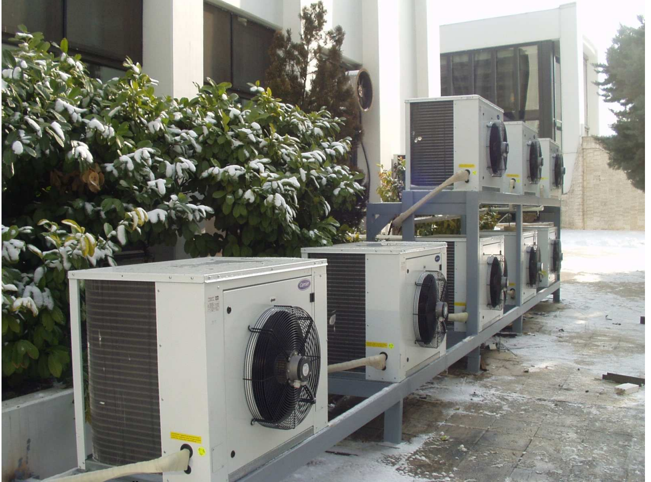
Soğuk Depo Dış Ünite Yerleşimi
